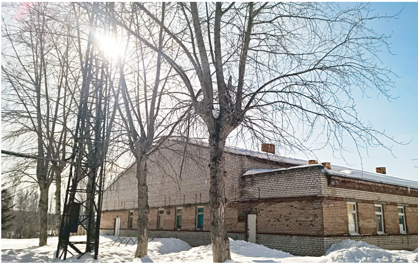
Сейчас здание крытого корта фигурного катания признано аварийным
