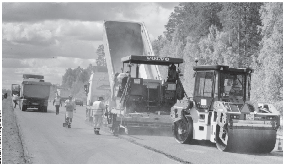
Сегодня участок Серовского тракта ремонтируется в рамках проекта «Безопасные и качественные дороги». Начальник Управления автомобильных дорог Вячеслав Данилов прокомментировал: «До 2020 года планируется привести в нормативное состояние участок тракта протяженностью 16,7 км. Из них 10 км – в нынешнем году».
